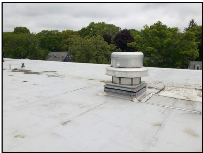
EXISTING EXHAUST FAN NO SCALE
