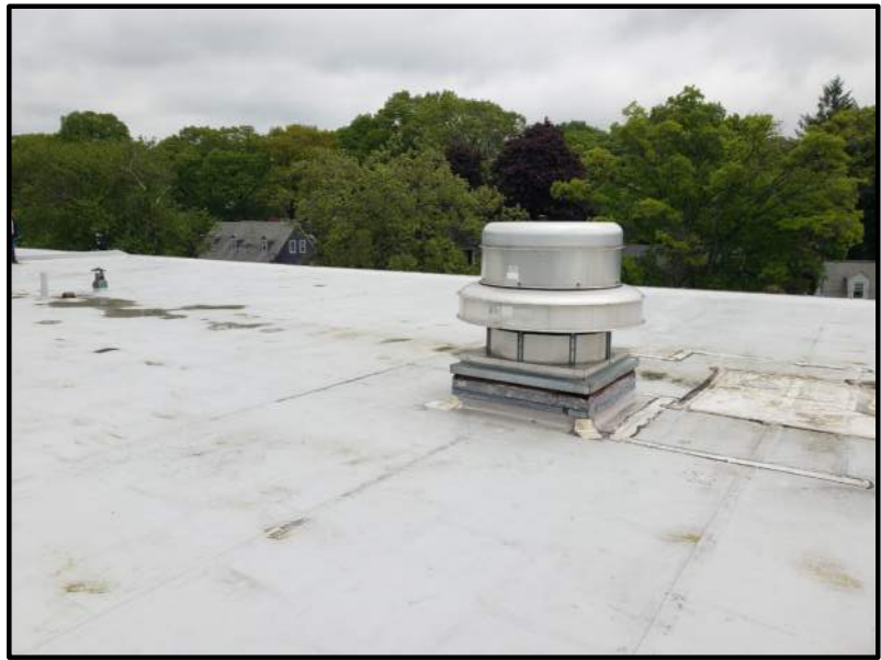
EXISTING EXHAUST FAN NO SCALE
